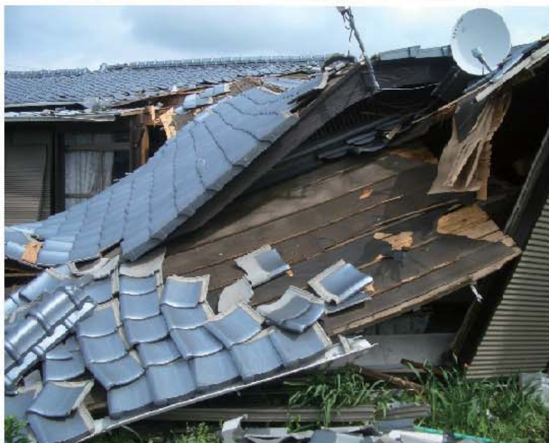
4月14日の震度7に耐えた知人宅も16日の震度7で無残に倒壊した
